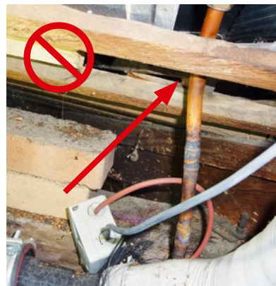
[FIG. 33] Legno a contatto con condotte surriscaldate.
