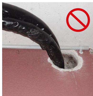
[FIG. 35] Penetrazione non otturata tra l'esterno e la cantina.
