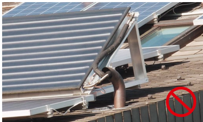
[FIG. 39] Il materiale isolante scivola verso il basso. Vi è il rischio che l'acqua meteorica penetri nel tubo di rivestimento e quindi all'interno dell'edificio. I raccordi sul collettore non sono isolati, il cavo della sonda è aggrovigliato ed esposto ai raggi UV.
