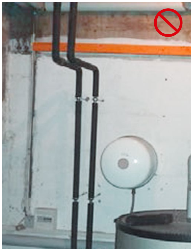
[FIG. 36] Perdite termiche importanti: condotta lunga in un locale interno non riscaldato. Materiale isolante elastomero troppo sottile (ca. 13 mm), posato in modo discontinuo, talvolta non a regola d'arte, contatto diretto della condotta non isolata con il suo supporto (ponte termico!).
